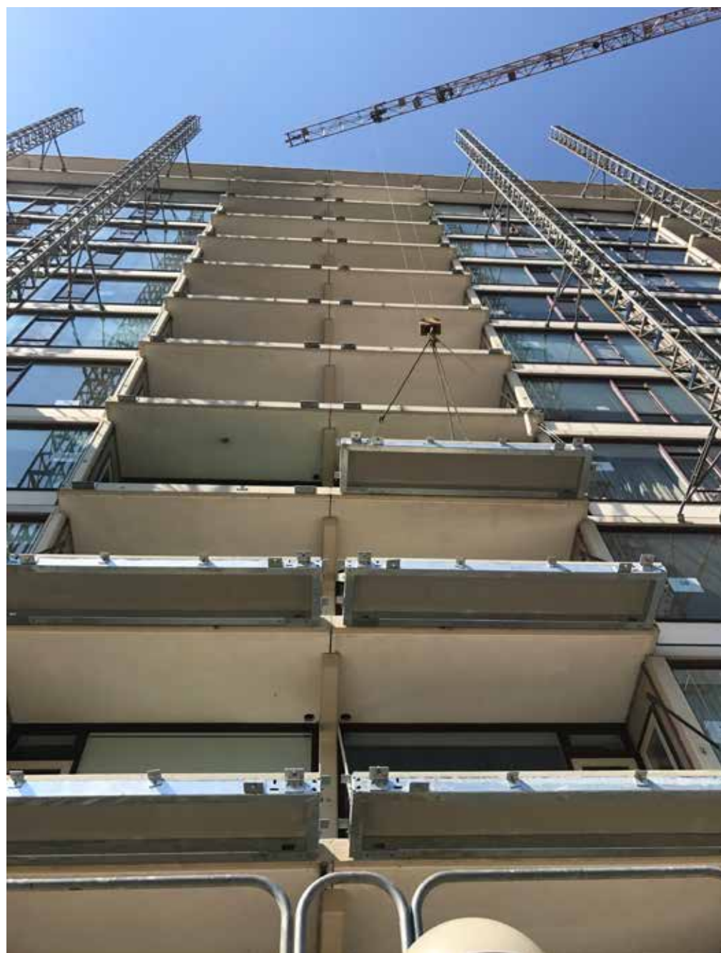
Door een gecertificeerde Nederlandse montagepartner van Balco worden nieuwe, grotere betonvloerplaten verankerd in de huidige consoles van het gebouw.
